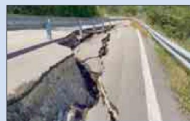
La frana sull'ex Ss 92 di Terranova di Pollino
